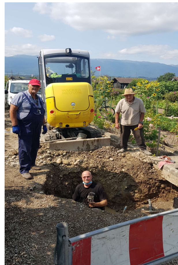
Fuite d'eau au jardin
